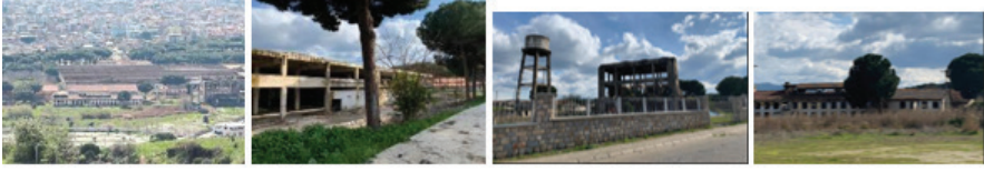
Şekil 16. Aydın Tekstil Fabrikası yenileme öncesi kuzey cepheden ve dış duvarlardan görüntüleri (Kaynak: 1. resim Yörükce, 2016, diğerleri S.Baysan, 2021).
