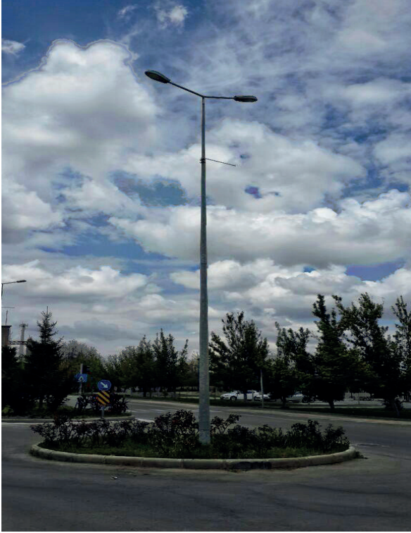
Şekil 3. Yerleşke anayol aydınlatmasında kullanılan armatür - 2
