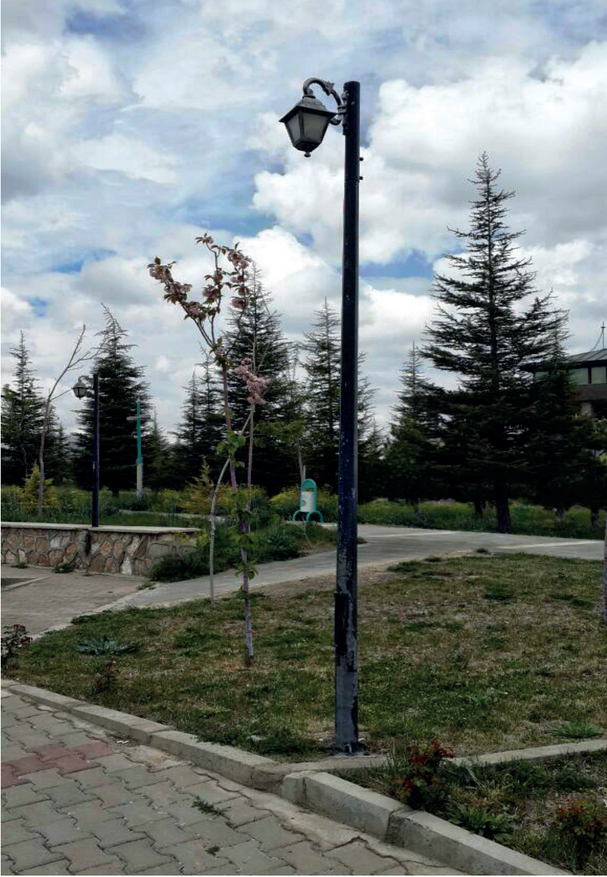
Şekil 9. Yerleşke yeşil alan aydınlatmasında kullanılan armatür-2
