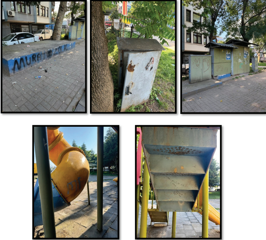
Şehit Fahrettin Mutaf Parkı içerisinde yer alan Vandalizm'e uğramış donatı elemanları (Kişisel Arşiv, 2024)
