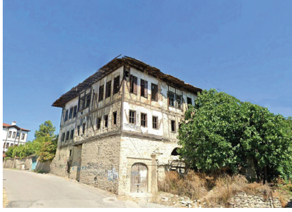
Şekil 11. Safranbolu Barış Mahallesi'nde Bulunan Hasar Gören Eski Konut Yapı
