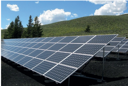
Şekil 7. Fotovoltaik panel örnekleme görselleştirmesi. Kaynak: ( URL 7 )
