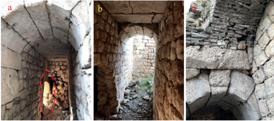
Resim 11. Apsisin kuzey duvarındaki kapı (a), kapının açıldığı koridor (b), beşik tonoz kalıntısı (c)
