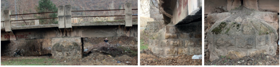
Şekil 17. İnce Yonu Bosajlı Taş Ayak ve Üzerindeki Çiftli-Açıklık Arası Tekli Betonarme Baba-İki Sıra L Profilli Demir Korkuluk Detayları
