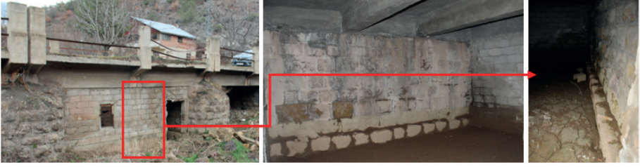
Şekil 45. Mansap Cephesinde Değişen Toprak Dolgu Kotundan Zemin Oturumları ve Kapatılmış Ayak Aralarında Görülen Ampatman Çıkıntıları
