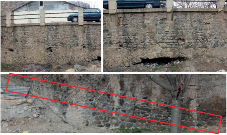
Şekil 38. Mansap Cephesi Tempan Duvarında Görülen İki Ayrı Örgü Düzeni ve Özgün Kısma Yönelik Müdahale İzleri
