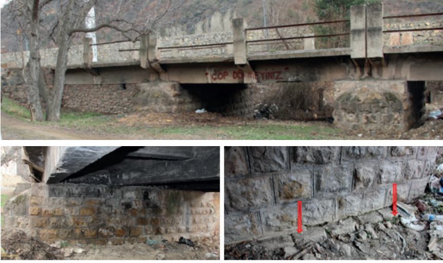
Şekil 43. Membede Cephesinde Değişen Toprak Dolgu Kotundan Görülen Ayakların Zemin Oturumu ve Açığa Kalan Ayaklarda Tek Bir Noktada Görülebilen Ampırtman Çıkıntısı
