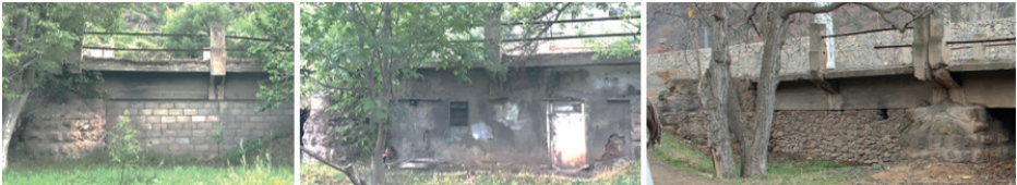
Şekil 34. Memba Cephesinde Dönem Eki Olarak Uzatılan Kısımlarda Kapatılan Açıklıklar
