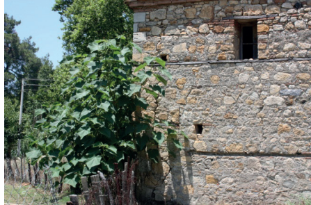
Resim 20. Güney Cephe'de taş örgüde oluşmuş strüktürel çatlak
