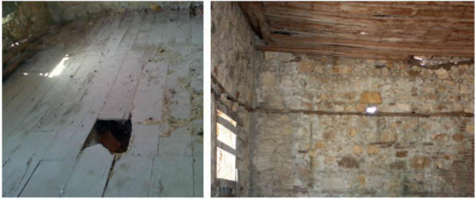
Resim 30-31. Döşeme ve tavan kaplamalarında kullanılan ahşap malzemede görülen bozulmalar
