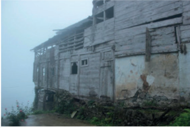
Şekil 7. Harap yapı, Küşüve Köyü Yukarı Mahalle (Pamukçu Cebeci, 2021)
