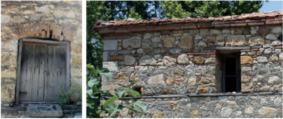
Resim 33-34. Tuğla kemerlerde malzeme kaybı, tuğla saçaklar
