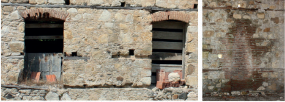
Resim 32-33. Tuğla kemerlerde malzeme kaybı, Mihrapta tuğla örgüde renk değişimi
