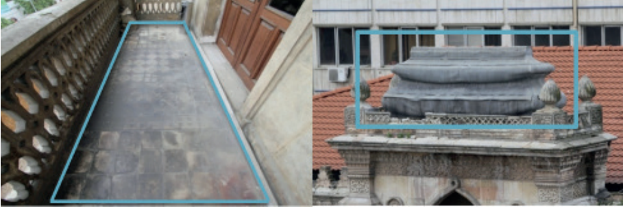
Şekil 12. Karosiman ve Kurşun Kaplamalarda Oluşan Hasarlar (Mostar-a, 2017)
