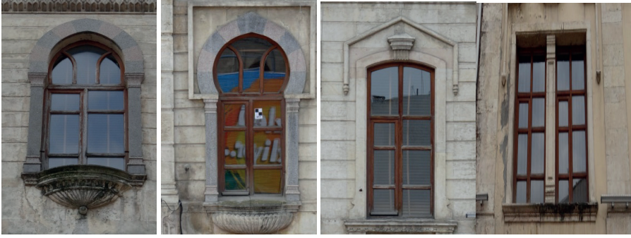
Şekil 7. Yapıdaki Pencere Tipleri ve Hasarları (Mostar-a, 2017)
