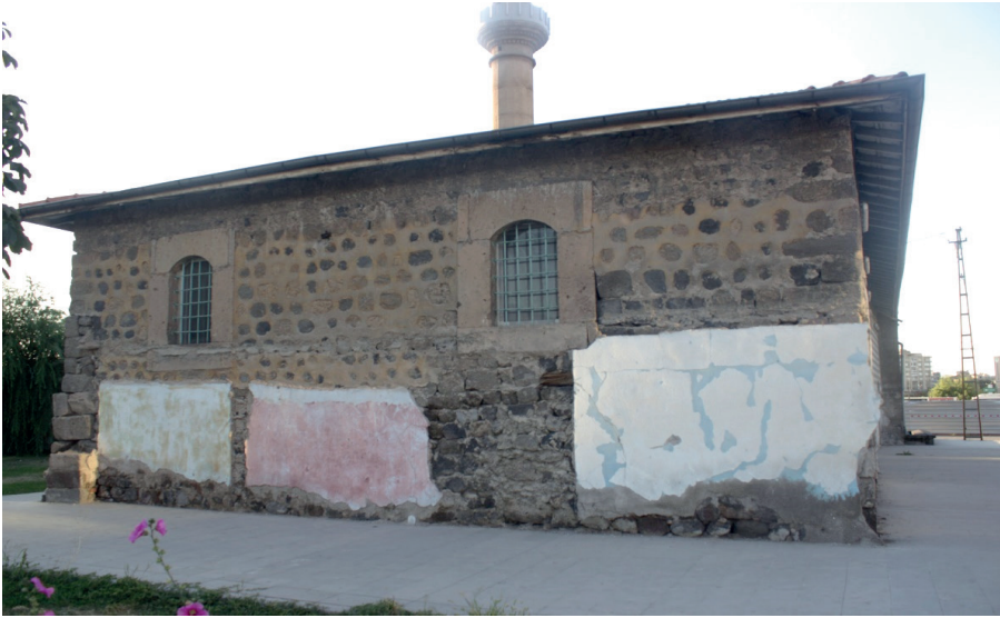
Şekil 17. Güney cephesi ve bozulmaların görünüşü
