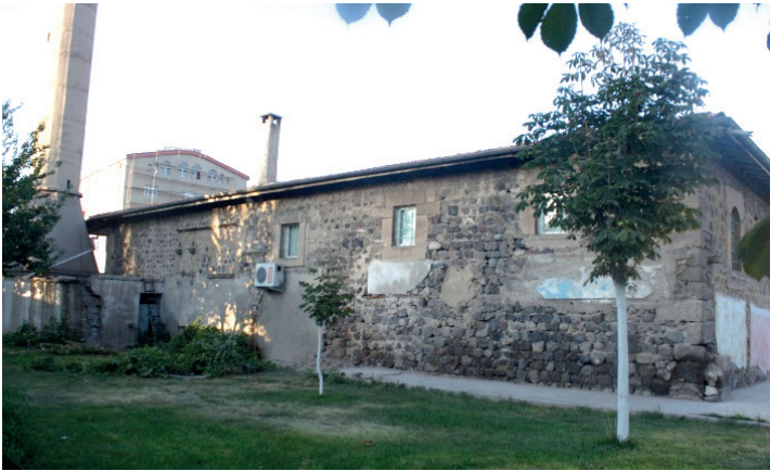
Şekil 19. Batı cephesi ve hasarların görünüşü
