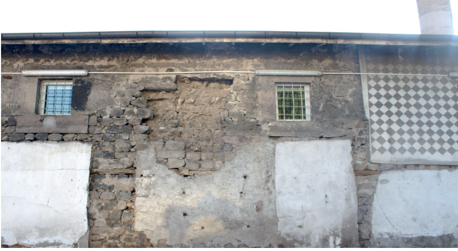
Şekil 18. Doğu cephesi ve hasarların görünüşü
