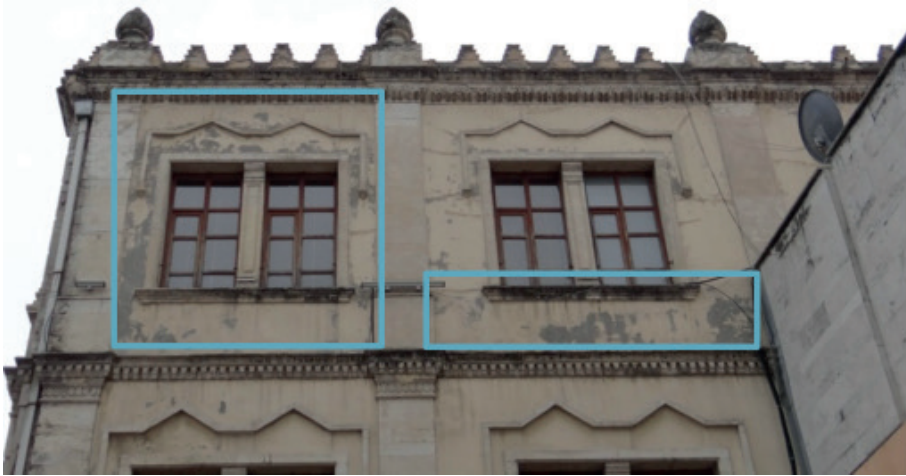
Şekil 11. Batı Cephesindeki Sıva Bozulmaları (Mostar-a, 2017)
