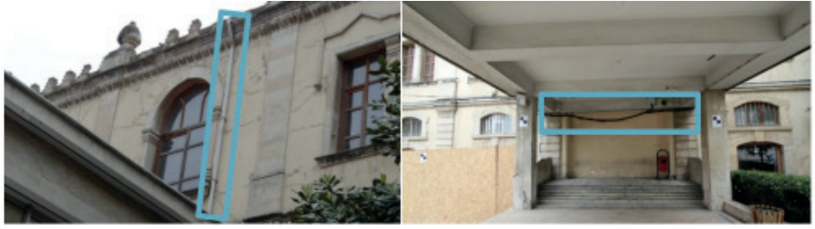
Şekil 13. Cephelerdeki Pvc Yağmur Oluğu ve Kablolar (Mostar-a, 2017)
