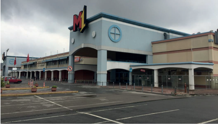
Şekil 14. Zamanla Tahrip Olmuş Cephe
