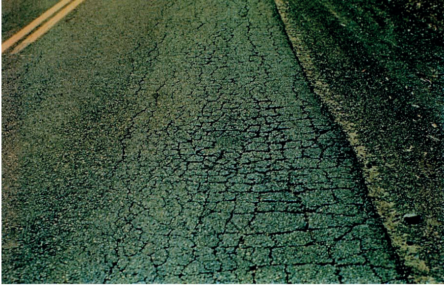
Şekil 3. Karayollarında yorulma çatlaklarının oluşumu (Pavementinteractive, 2025)
