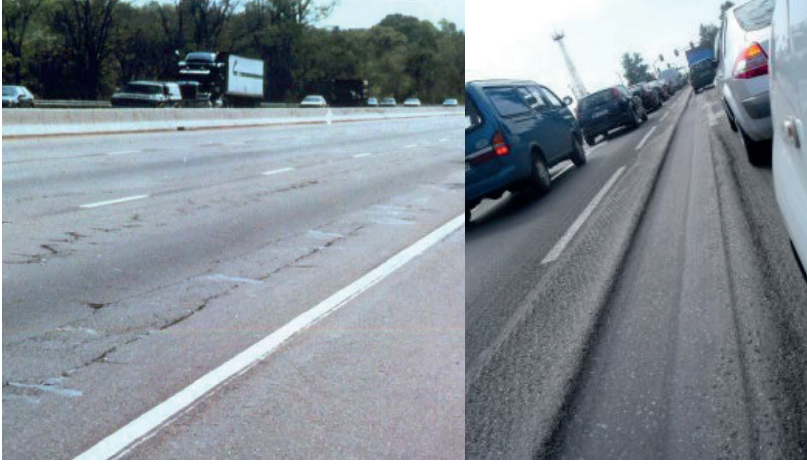
Şekil 1. Asfalt Yollarda Meydana Gelen Kusur ve Hasar Çeşitleri (İnsapedia, 2018)
