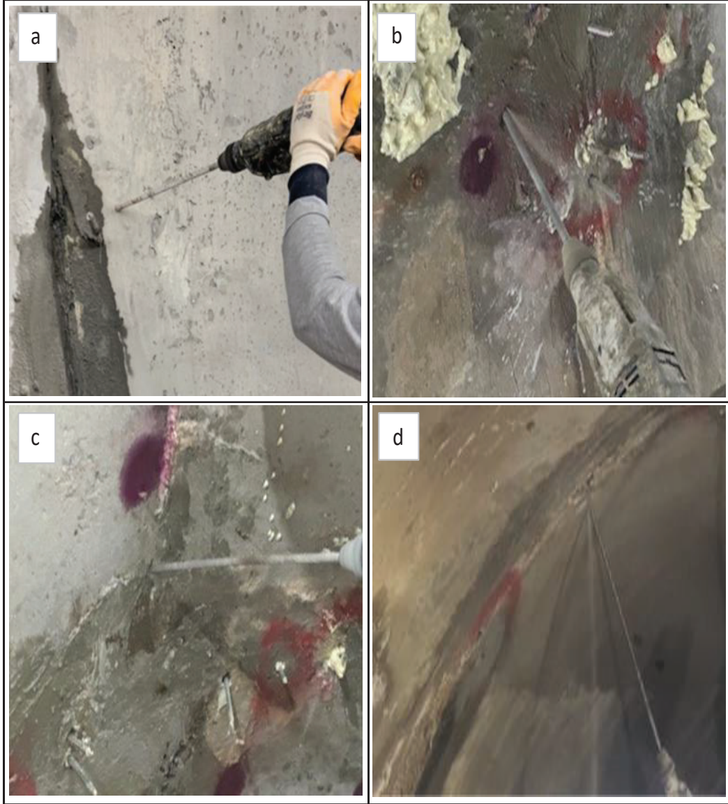
Şekil 5. Farklı açılarda açılmış kimyasal enjeksiyonu delgi kesitleri (a) 90°, (b) 60°, (c) 45°, (d) 30° (Morgedik Barajı Derivasyon Tüneli).
