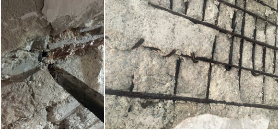
Şekil 1. Çelikte korozyon sebebiyle oluşan kopma Şekil 2. Betonarmede çeliğin korozyonu
