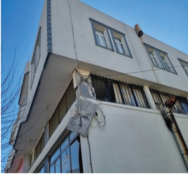
Şekil – 2: Kısa Kolon Etkisinde Kalan Bina Örneği (URL_1)
