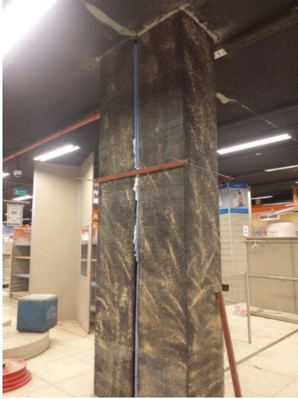
Şekil – 6: Yetersiz Dilatasyon (Deprem) Derzi Bırakılması Sonucu Orta Hasar Alan Bina Güçlendirme Örneği: Osmaniye İli (Arşiv)
