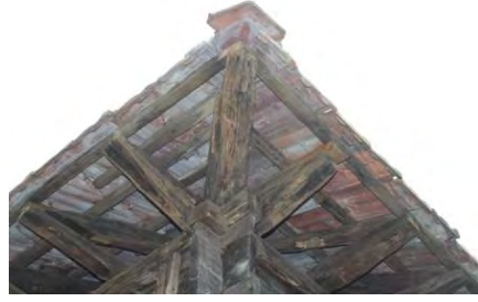
Görsel 4.551. Karacaören Köyü Necmi Tekin Sereni çatı saçağı
