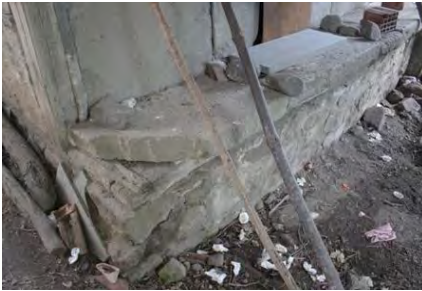
Görsel 4.601. Alan Köyü Yusuf Arslan Fırını ana yapı ahşap hatıl ve tezgâh ayrıntısı
