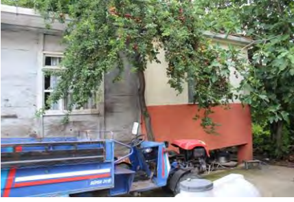
Görsel 4.230. Alan Köyü Celalettin Somuncu Evi kuzey cepheye eklenen muhdes bölüm
