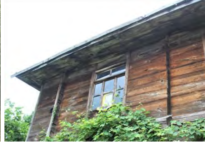
Görsel 4.153. Alan Köyü Muhittin Şensoy Evi çatı saçağı
