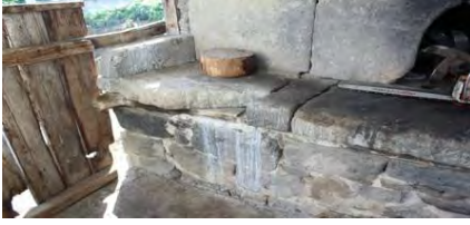
Görsel 4.577. Alan Köyü İsmet Şensoy Fırını ahşap hatıllı moloz taş duvar ve tezgâh ayrıntısı
