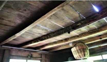
Görsel 5.153. Alan Köyü Muhittin Şensoy Evi'nin zemin katında yer alan odanın tavanı
