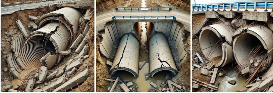
Şekil 6. Deprem etkisine maruz kalmış menfez hasarları “Yazar tarafından hazırlanmıştır.”
