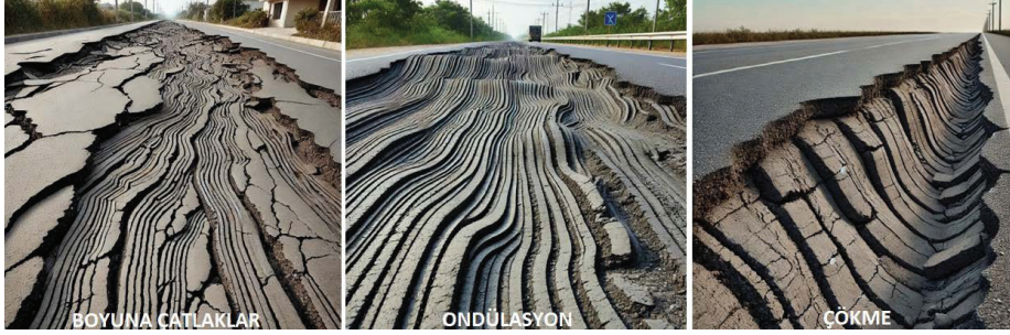
Şekil 2. Deprem sonrası yorulma etkisine maruz kalan karayolu hasar türleri “Yazar tarafından hazırlanmıştır.”
