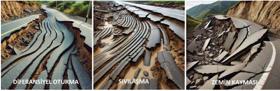
Şekil 1. Deprem sonrası karayolunda diferansiyel oturma-sıvılaşma-zemin kayma hasarları “Yazar tarafından hazırlanmıştır.”
