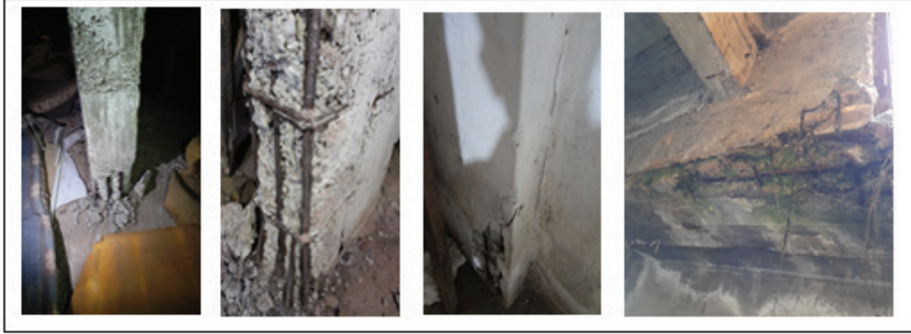
Şekil 5. İncelenen binaların bodrum katlarında su ve neme bağlı bozulmalar
