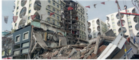
Şekil 5. Deprem esnasında yıkılan Galeria AVM sitesi (Yenişehir) (Url 10)
