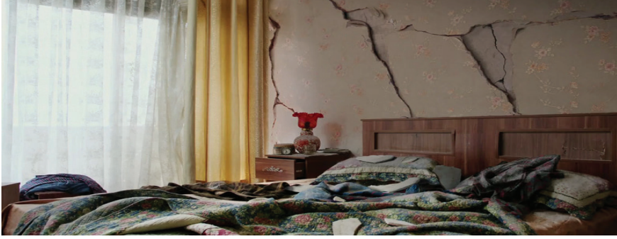
Görsel 50. Açılış Görseli: Duvarları Çatlayan Dağınık Yatak Odası
